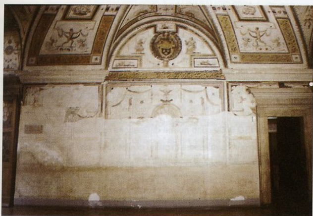
Fig. 9 - Sala di Apollo, Castel Sant'Angelo, Roma: veduta della parete Nord in cui è presente un localizzato fenomeno di degrado nella porzione adiacente l'ingresso (15).
