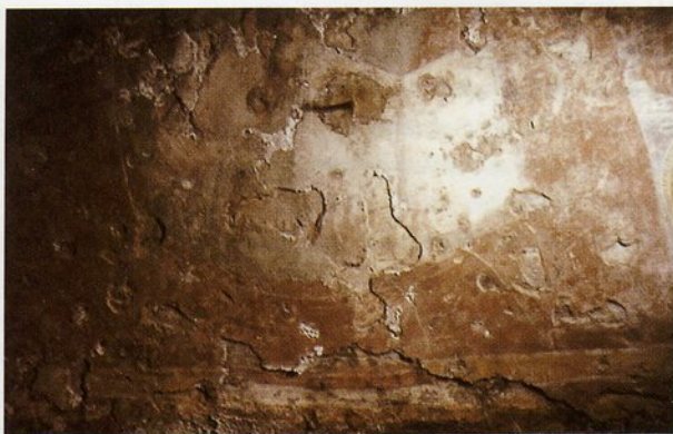
Fig. 6 - Chiesa di Santa Maria del Parto, Sutri: frammento di dipinto murale, particolare di una lacuna in cui è presente una grappa in ferro (12).
